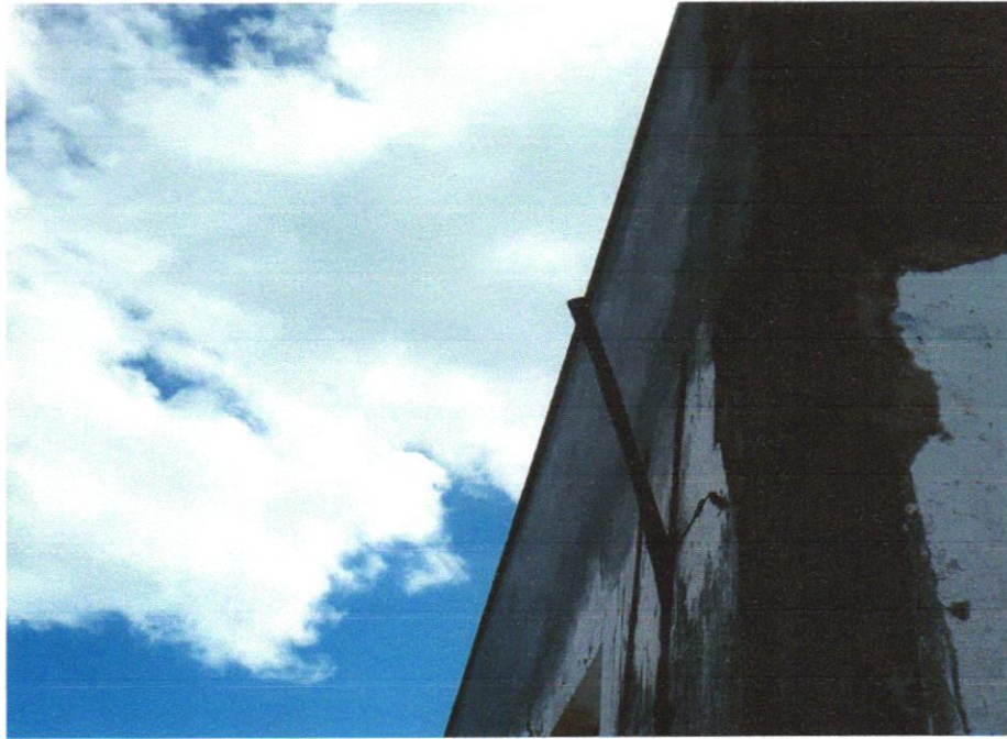
Foto 03 - Chapim de concreto pré-moldado
