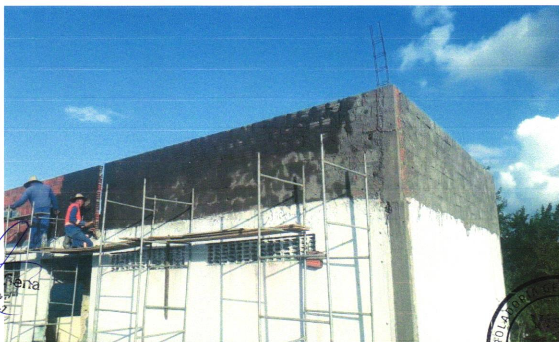
Foto 12 - CHAPISCO APLICADO EM ALVENARIA (COM PRESENÇA DE VÃOS) E ESTRUTURAS DE CONCRETO DE FACHADA, COM EQUIPAMENTO DE PROJEÇÃO. ARGAMASSA TRAÇO 1:3 COM PREPARO EM BETONEIRA 400 L. AF_06/2014
