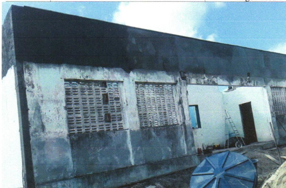
Foto 15 - MASSA ÚNICA, PARA RECEBIMENTO DE PINTURA OU CERÂMICA, ARGAMASSA INDUSTRIALIZADA, PREPARO MECÂNICO, APLICADO COM EQUIPAMENTO DE MISTURA E PROJEÇÃO DE 1,5 M 3 /H EM FACES INTERNAS DE PAREDES, ESPESSURA DE 5MM, SEM EXECUÇÃO DE TALISCAS. AF_06/2014
