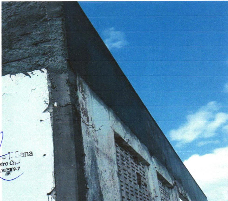
Foto 04 - Chapim de concreto pré-moldado
