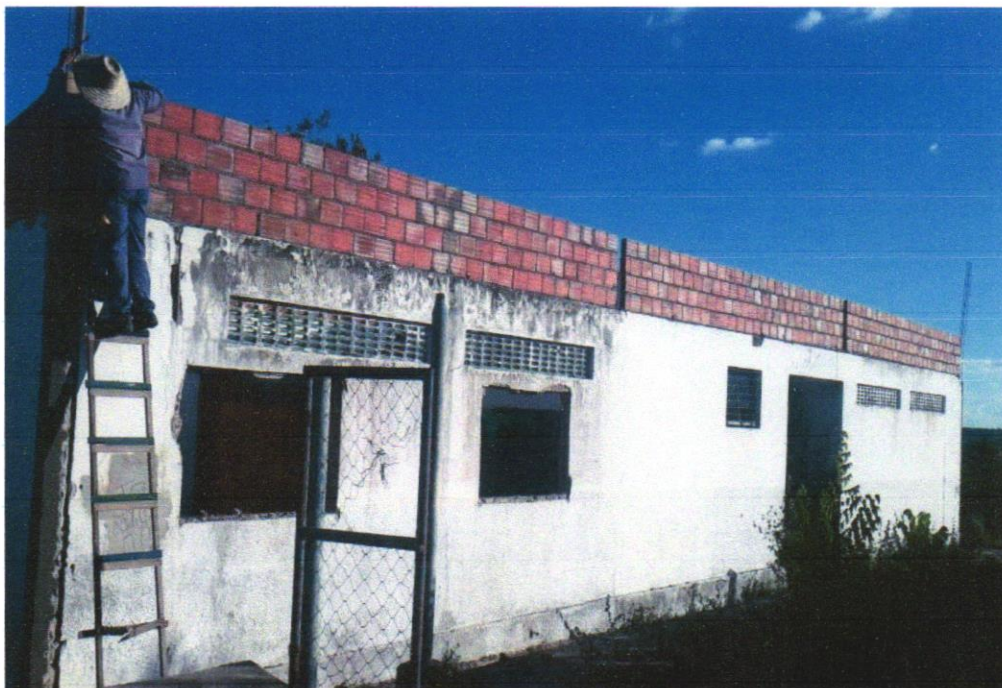
Foto 05- ALVENARIA DE VEDAÇÃO DE BLOCOS CERÂMICOS FURADOS NA HORIZONTAL DE 9X19X29 CM (ESPESSURA 9 CM) E ARGAMASSA DE ASSENTAMENTO COM PREPARO EM BETONEIRA. AF_12/2021
