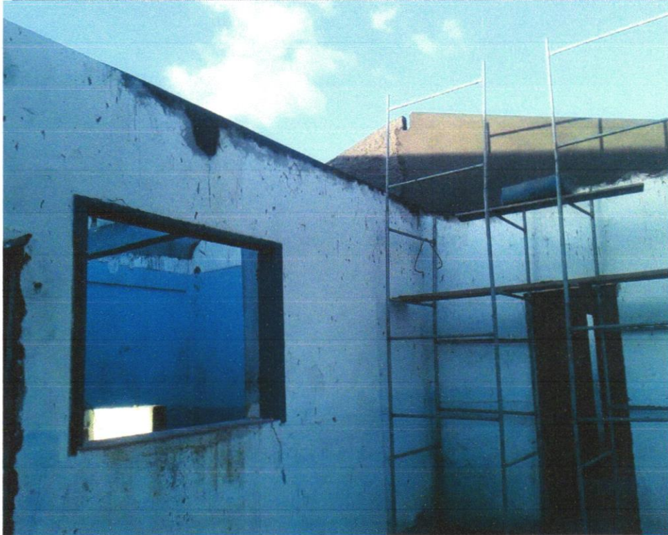
Foto 17 - MASSA ÚNICA, PARA RECEBIMENTO DE PINTURA OU CERÂMICA, ARGAMASSA INDUSTRIALIZADA, PREPARO MECÂNICO, APLICADO COM EQUIPAMENTO DE MISTURA E PROJEÇÃO DE 1,5 M 3 /H EM FACES INTERNAS DE PAREDES, ESPESSURA DE 5MM, SEM EXECUÇÃO DE TALISCAS. AF_06/2014
